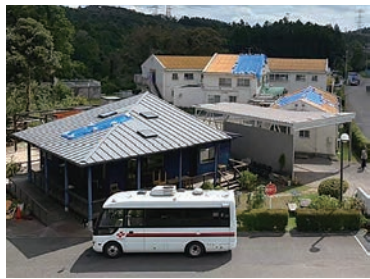
壊れた屋根に張られたブルーシート
