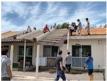
あかねの里屋根、大きく破損
